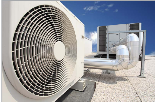
Aus UV-stabilisierten TPOs gefertigte HLK-Gehäuse sind für einen breiten Temperaturbereich geeignet.
